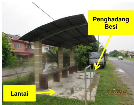
Gambar 3.5 Lantai Tiada Kemasan Jubin Dan Pengadang Besi Tidak Dicrome
