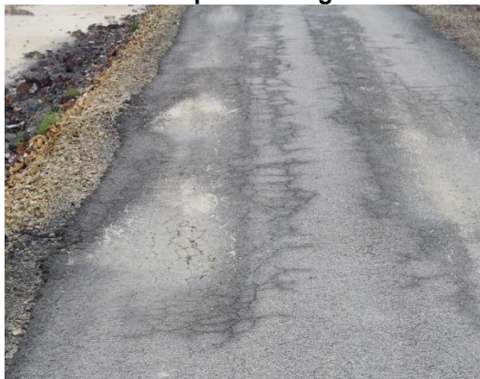
Gambar 1.6 Retak Di Tepi Dan Tengah Jalan
