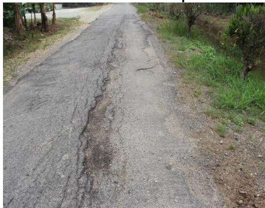
Gambar 1.5 Pecahan Dan Retak Tepi Jalan
