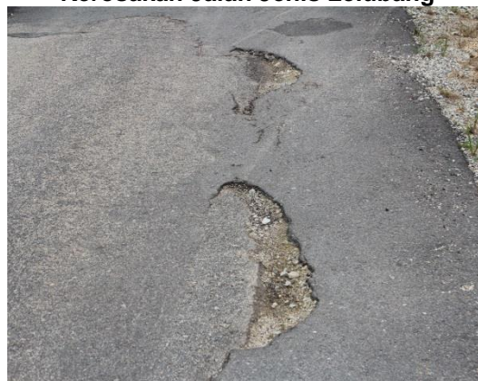
Gambar 1.10 Kerosakan Jalan Jenis Lelubang
