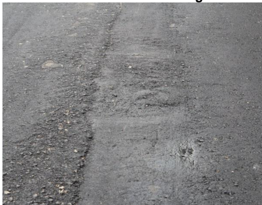
Gambar 1.11 Kerosakan Jalan Jenis Pengikisan
