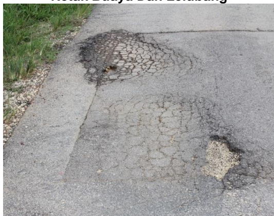
Gambar 1.9 Retak Buaya Dan Lelubang
