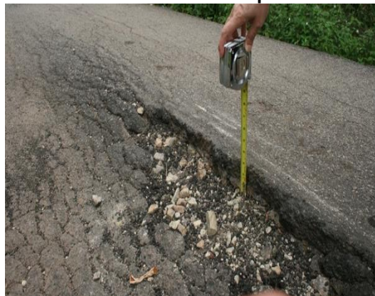
Gambar 1.12 Retak Dan Jatuhan Tepi Jalan
