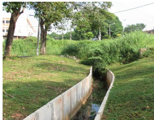
Gambar 3.6 Bendul Parit Tidak Dibina
