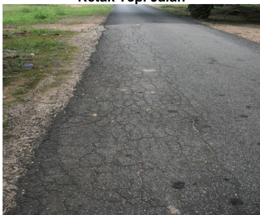
Gambar 1.7 Retak Tepi Jalan
