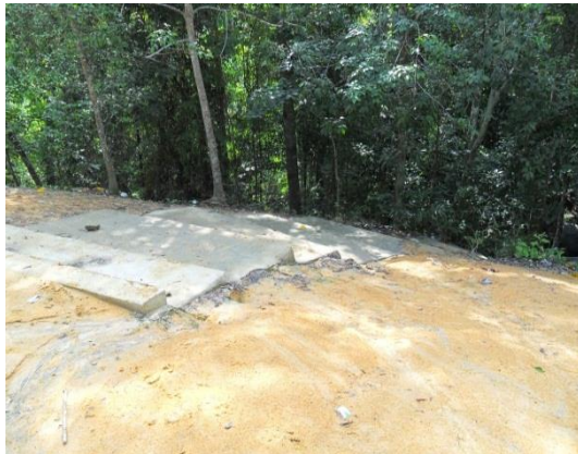
Gambar 3.3 Handrailing Tidak Dibina
