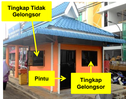
Gambar 3.1 Kerja Tidak Mengikut Spesifikasi
